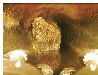
木根の侵入を捉えた撮影画像
