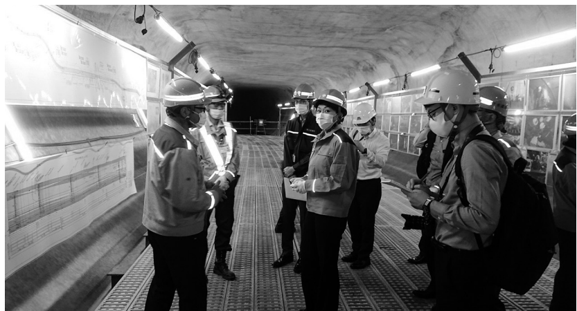
小淵優子衆議院議員(写真手前左から2人目)が東京都の現場(立会川幹線雨水放流管H&Vシールド工法スパイラル掘進工事)を視察
